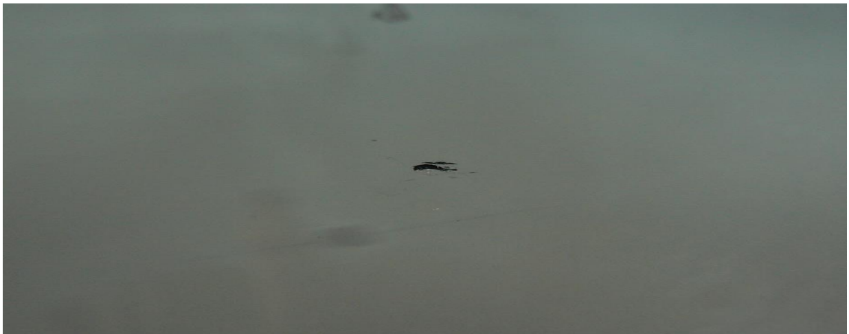
FOUT: Sterreparatie voldoende gevuld maar oppervlakte niet afgewerkt.
