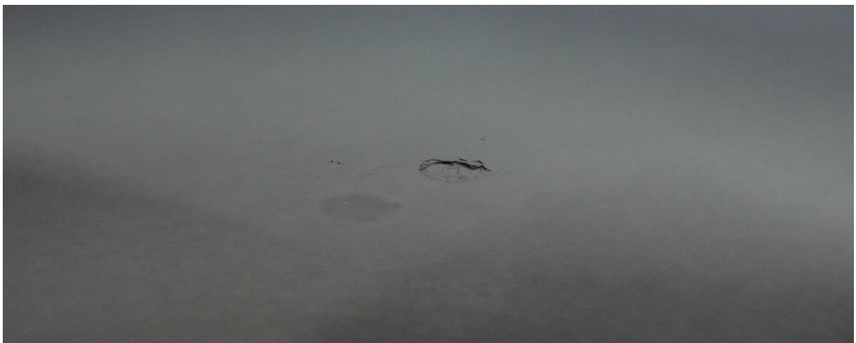
FOUT: Breuk voldoende gevuld en voldoende hechting, maar oppervlakte niet afgewerkt.
