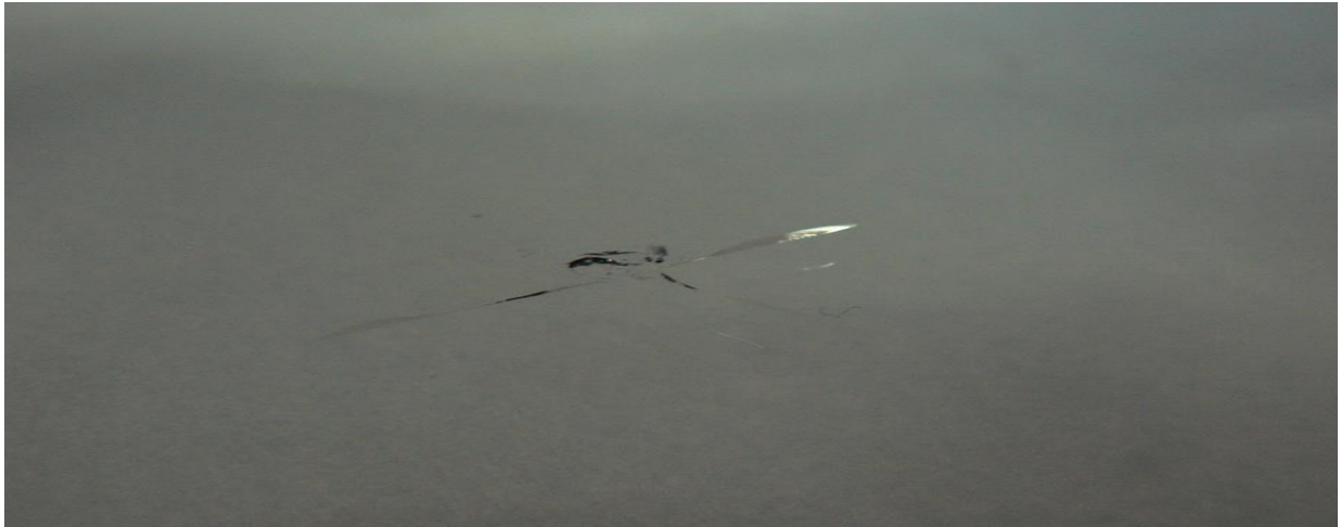
FOUT: Sterreparatie onvoldoende gevuld.
